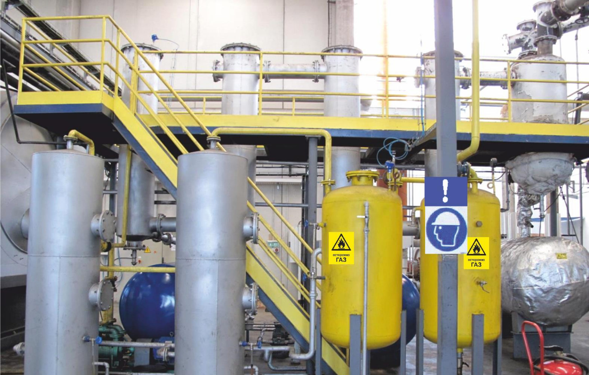
СИСТЕМА КОНДЕНСАЦИИ И ОЧИСТКА СИНГАЗОВ
